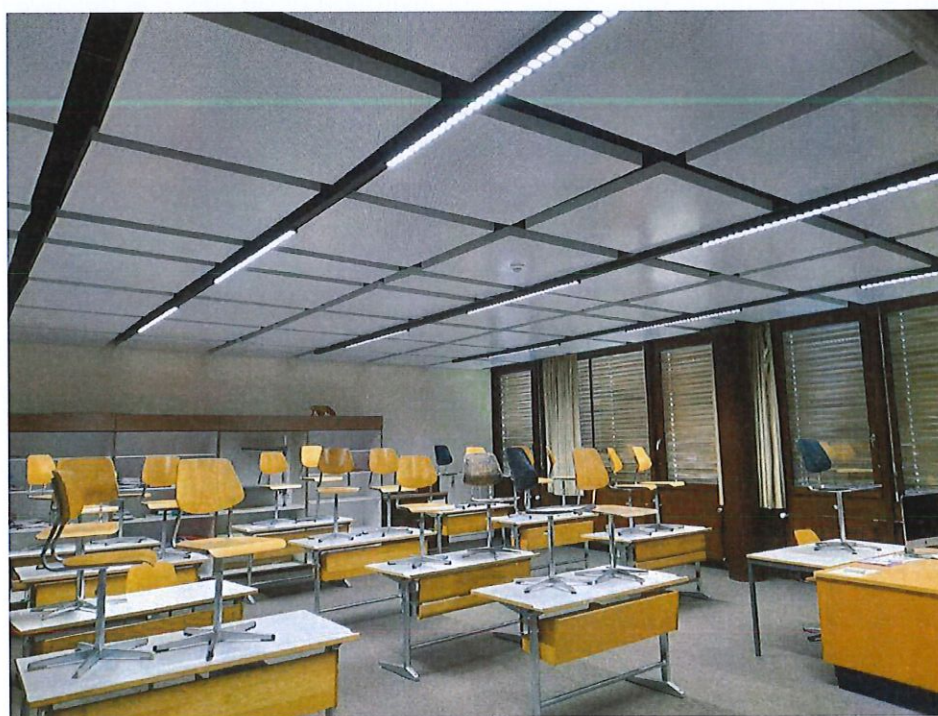
Salle de classe équipée des nouveaux luminaires LED
